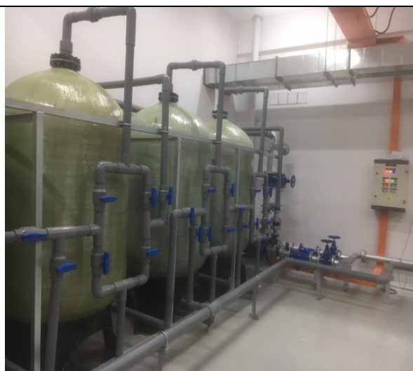
Hệ thống làm mềm nước – Soft water system
