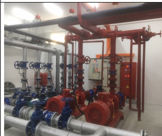
Hệ thống Bơm – Water pumps system
